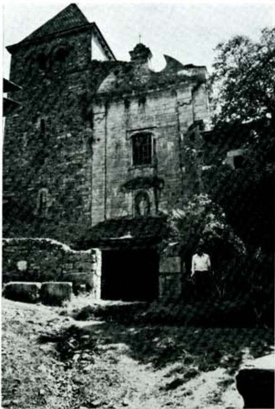
Lámina 4.—La fachada de la iglesia es la parte más valiosa de la arquitectura de Montes. Aun así son bien claras las huellas de su degradación. Benigno, impotente ante tanto que cuidar, no deja de quejarse por el abandono.
