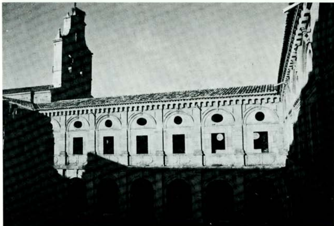
Lámina 10.—También se restauró parte del claustro barroco próximo a la iglesia, que presenta un aceptable estado. Mientras un ala de ese mismo claustro aparece totalmente arruinada.
