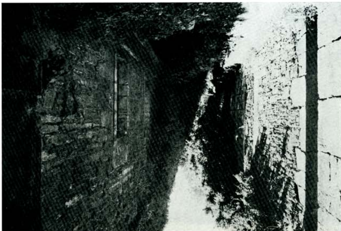
Lámina 1.—Como consecuencia del incendio se derrumbaron las estructuras horizontales del monasterio de San Pedro de Montes. Permanecen firmes los muros dominados por una vegetación espléndida.
